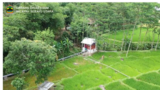
Gambar 5 Pipa pesat dan rumah turbin PLTMH Gringgingsari (Cabang Dinas ESDM Wilayah Serayu Utara, 2023)
